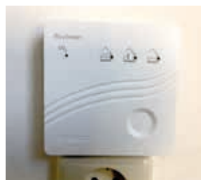
Hoofdbediening mechanische ventilatie
